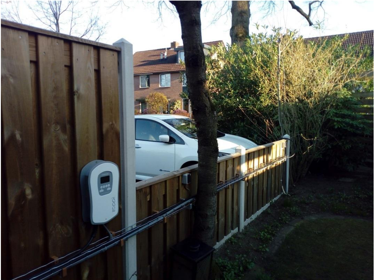
Parkeerplaats elektrische auto en links het Zappi laadstation.
