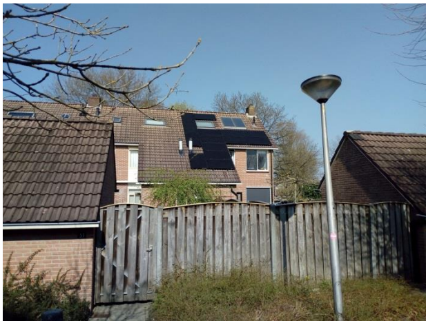
Zonnepanelen met warmwater voorziening.
